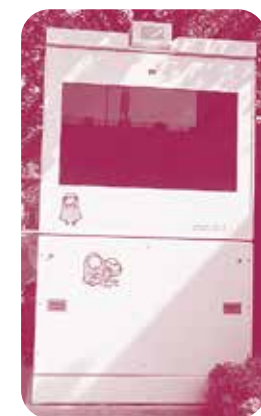
電源が切れたままのデジタルサイネージ(電子看板)
